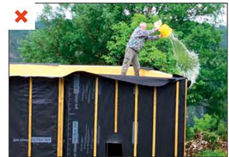
▲ Le bâtiment non protégé (notamment les éléments bois au niveau de la toiture terrasse) est resté longtemps exposé aux intempéries avant d'être mis hors d'eau
