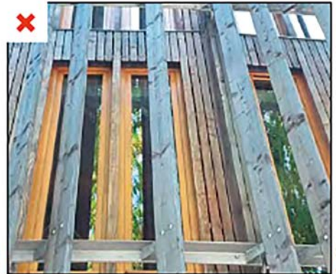
▲ Difficulté d'accès pour l'entretien des menuiseries extérieures due aux ventelles
