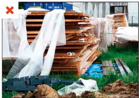
▲ Exemple d'un stockage d'éléments bois mal protégé des intempéries et en contact avec l'humidité du sol
